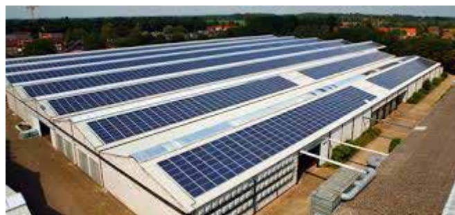
Ilustrasi Rooftop Solar Panel untuk industri
